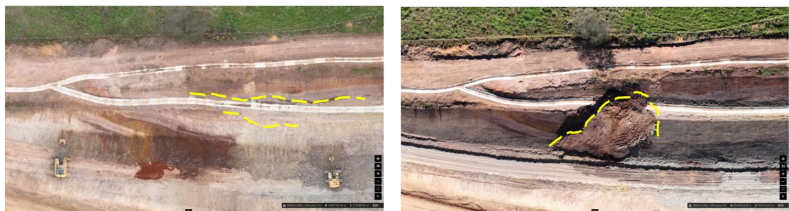
Figura 6: Ruptura no corte – imagens com diferença de 20 dias.
